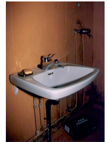
Dokumentasjonsbilde av et primitivt innredet bad i det tidligere pikeværelset i 2. etasje, hovedfløyen i Wessels gate 15.
